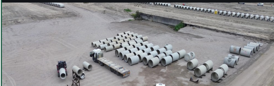
STOCKAGE ASSAINISSEMENT - Tuyaux & cadres béton
